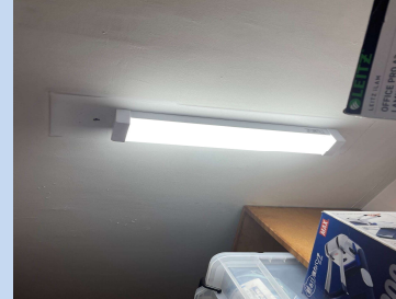
事務所倉庫（LED照明）
