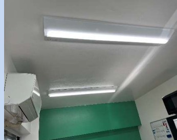
第一休憩室（LED照明）
